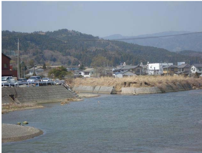
写真 2.3.2-3 合流部における護岸の破壊
