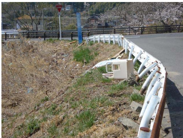
写真 2.3.2-4 堤内側に倒伏するガードレール
