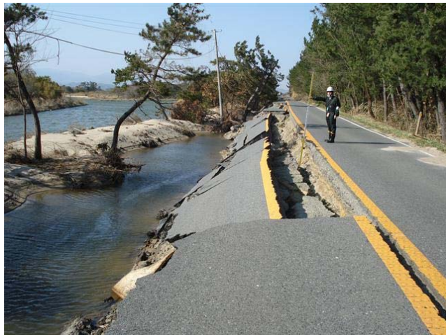
写真 2.3.1-2 段落ち流れによる道路の破壊
