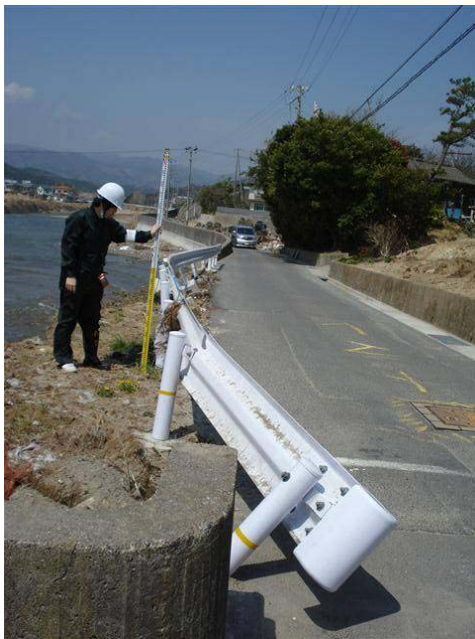
写真 2.3.2-2 堤内側に倒伏するガードレール
