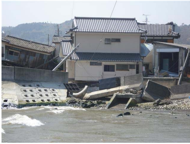
写真 2.3.2-1 河口部擁壁の転倒
