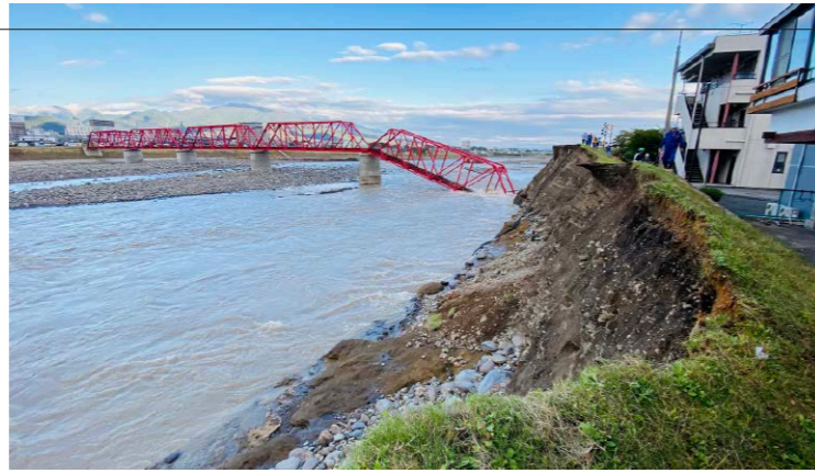
台風19号の増水に伴う大規模な堤防の侵食とそれに伴う上田電鉄の鉄道橋の落橋 (2019年10月15日) 筆者撮影
